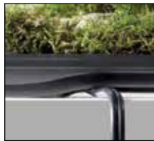
Canalón ligeramente elevado
